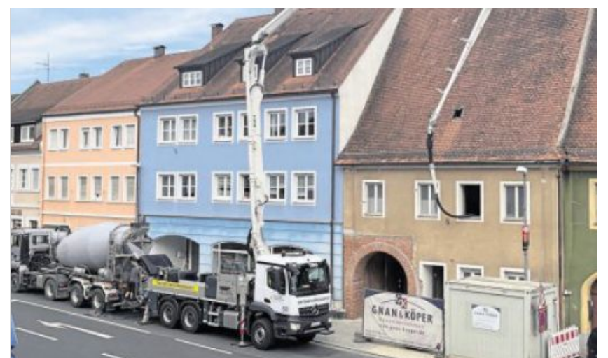
Große Gefährte waren notwendig, um die erste Zwischendecke im Groß-Anwesen (rechts) betonieren zu können. Mit einer leistungsfähigen Pumpe konnte der Beton in das Haus befördert werden.
